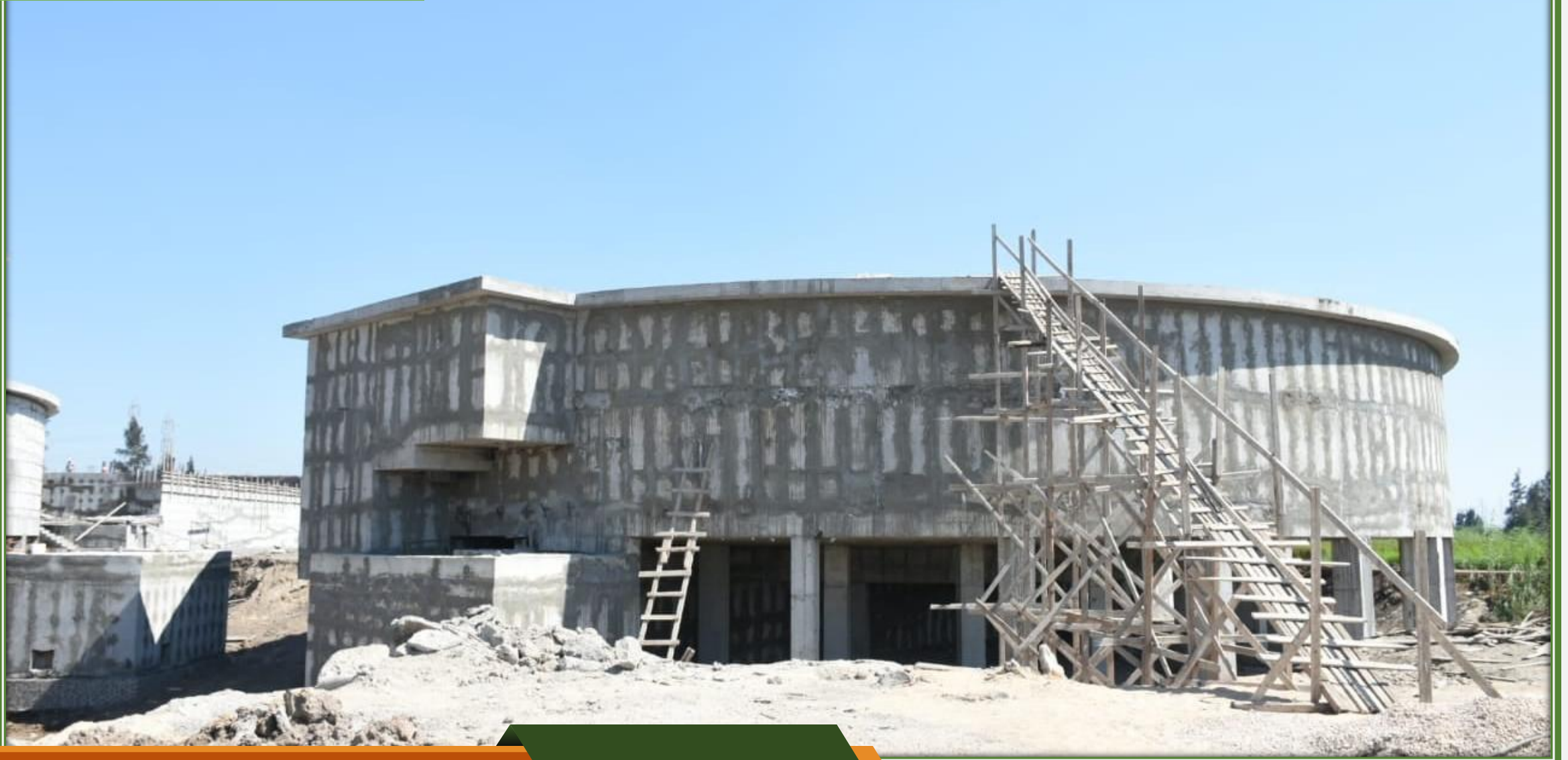
المشروعات الجارية محطة مياه البكارشة مركز الحسينية
